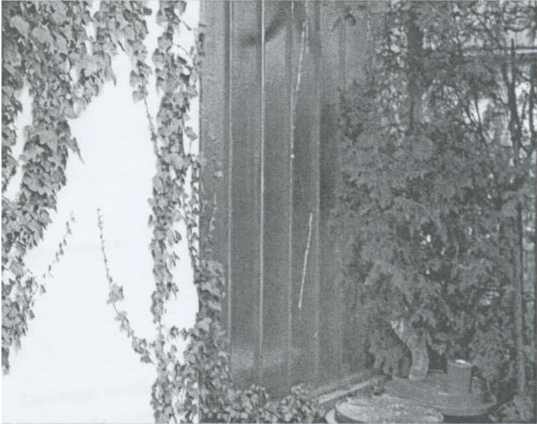
Durch den Steinwurf beschädigte Glasveranda
